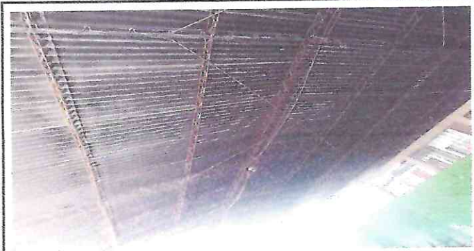
Foto 1. interior aula, (salon) barillas de hierro deterioradas.
